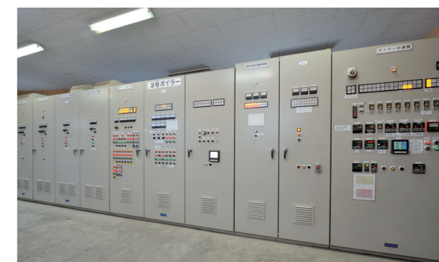
ボイラー制御室
