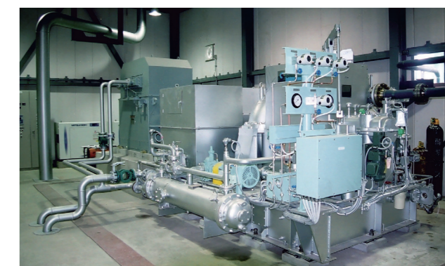
蒸気タービン
