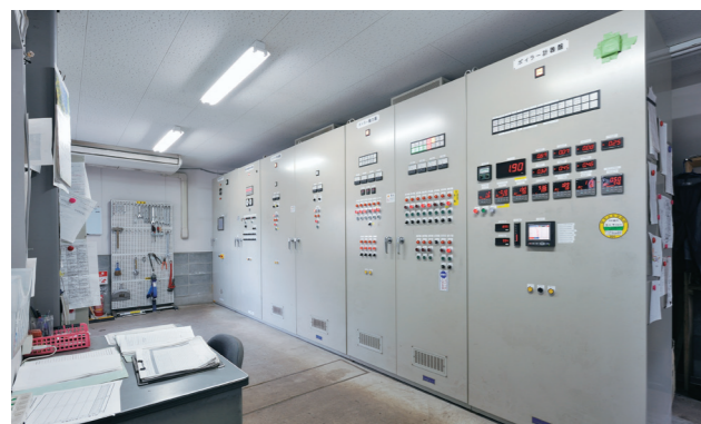
ボイラー制御室
