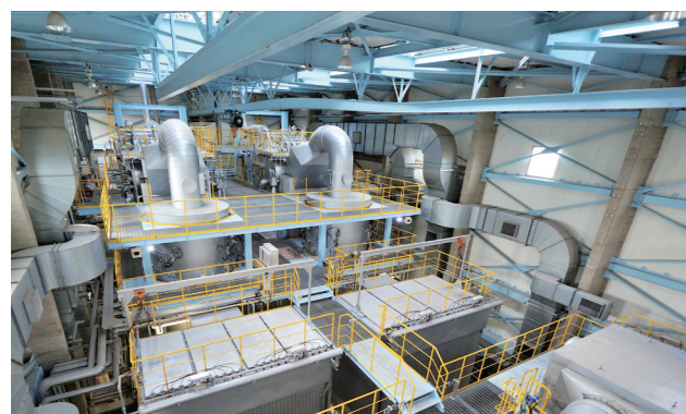
よしみね水管式廃熱ボイラ (2基)
