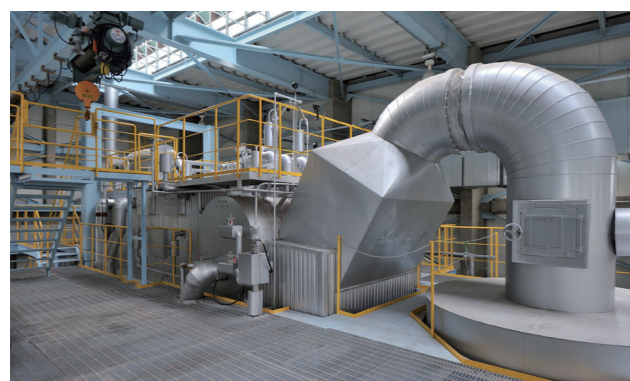
よしみね水管式廃熱ボイラ WA-460型
