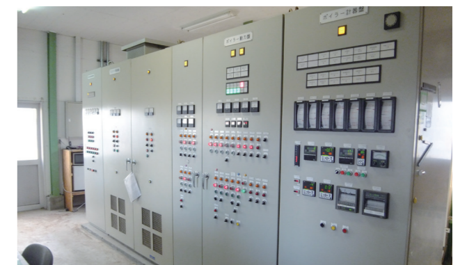
ボイラー制御室
