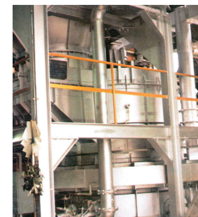
汚泥焼却炉(二段式)
