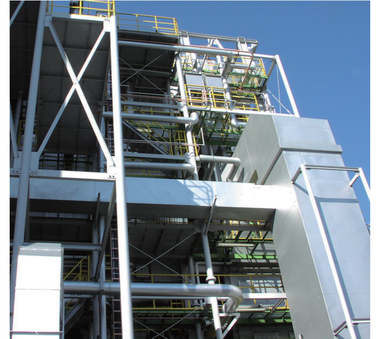
ペーパースラッジ焚きボイラーの側面
