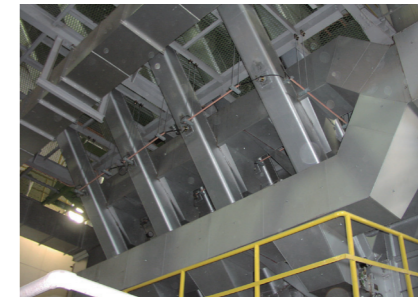
ペーパースラッジ・木屑投入シュート
