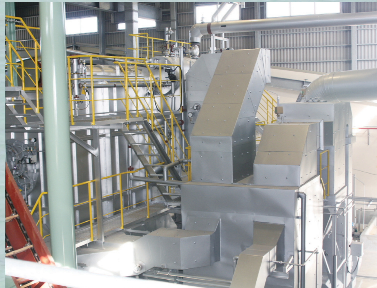
HAS-4000型 伊江村黒糖工場バガスボイラー
